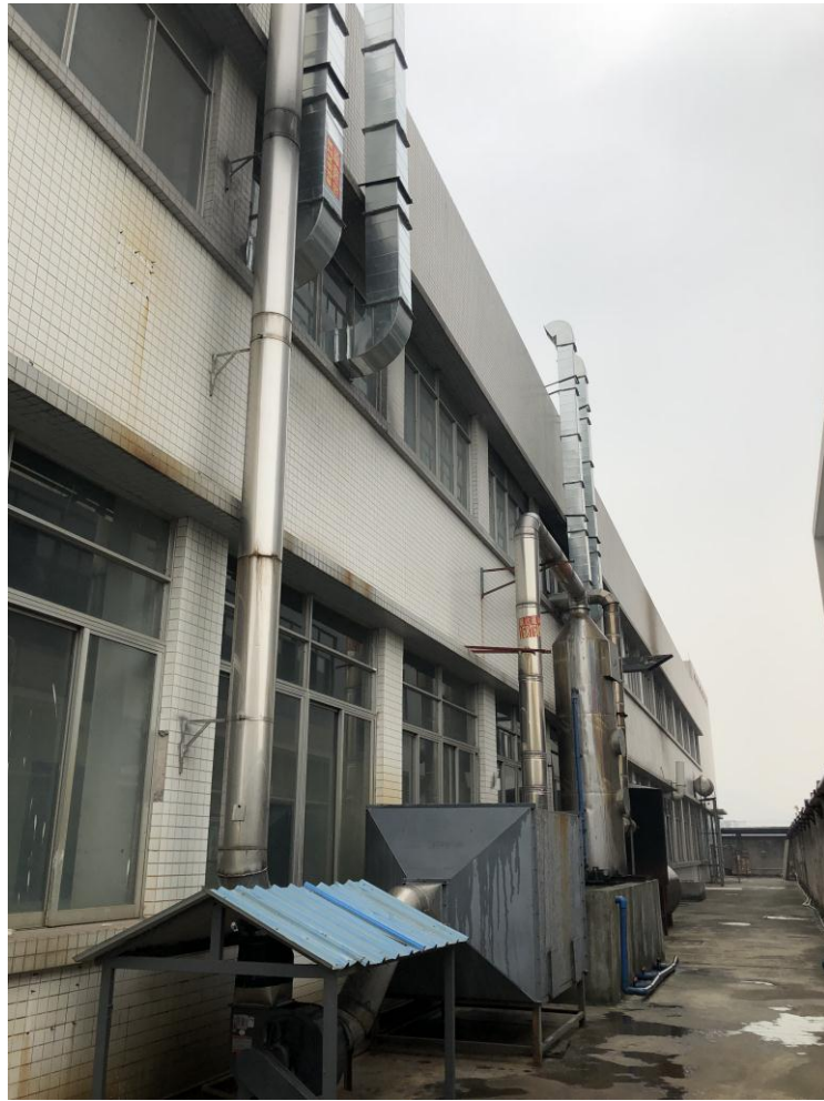
图 3.7-4 热固化、酸雾、柴油燃烧尾气共用废气处理装置
